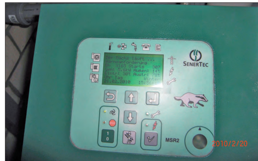
Abb. 62: Steuertableau eines BHKW, Foto: H. Lüdelling
