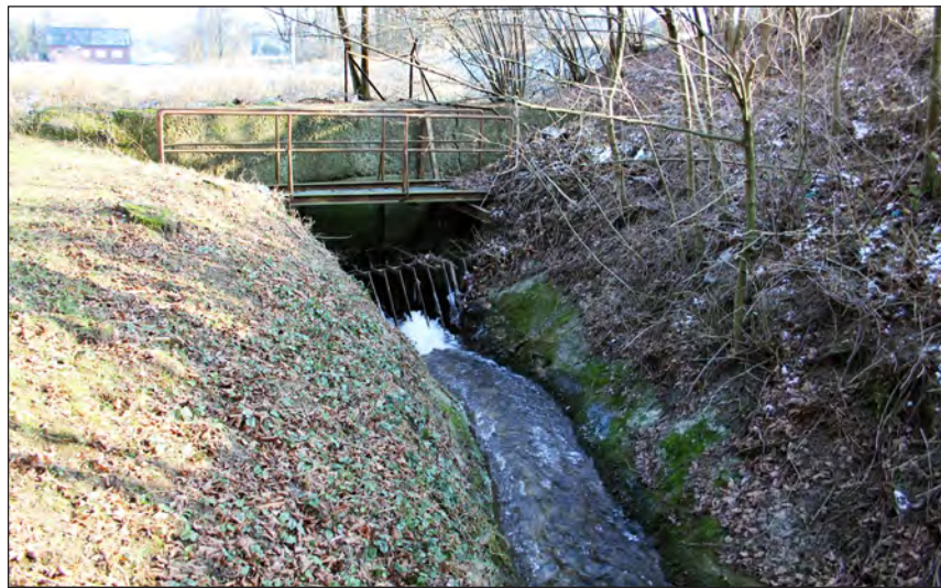
Abb. 75: Einlaufrechen und Flutmauer am Mühlenbach oberhalb des Sportplatzgeländes, Foto: H. Lüdeling
