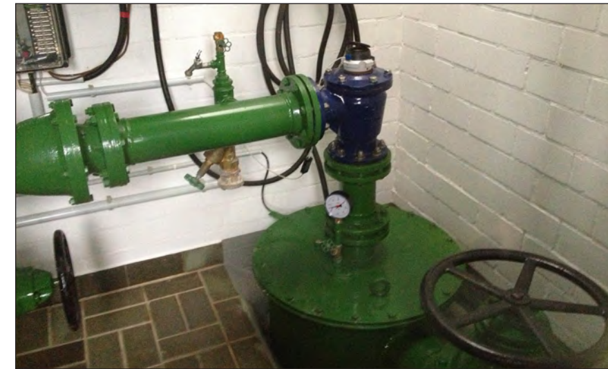
Abb. 10: Abdeckung des Gewinnungsbrunnens am Haus der Begegnung, Foto: H. Lüdeling
