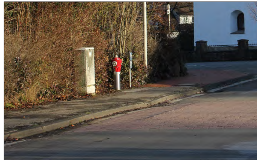
Abb. 52: Absackung des Gehweges mit Hochbord als Zugangsbarriere, Foto: H. Lüdeling
