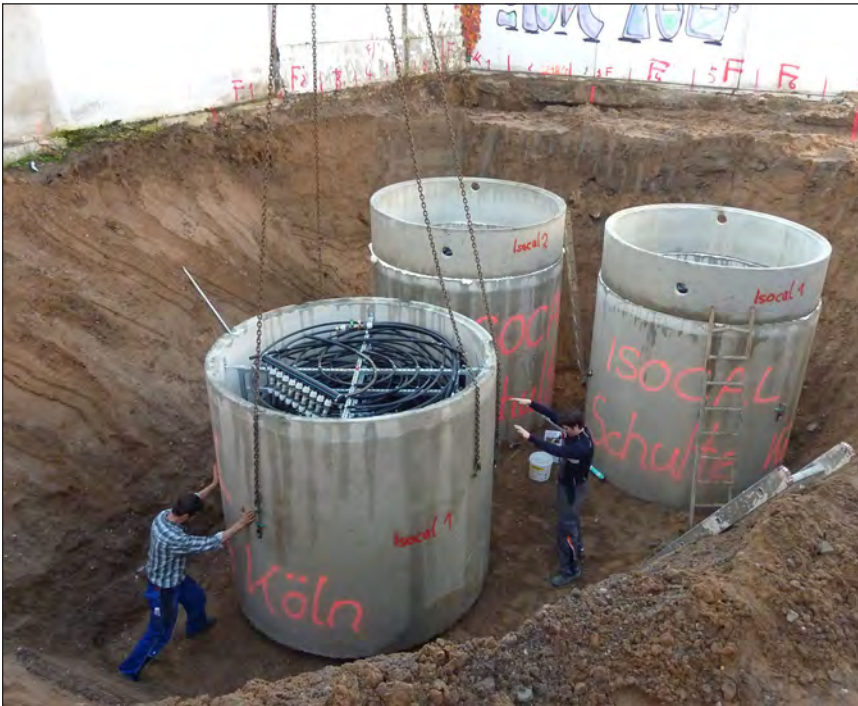
Abb. 63: Einbau von Solareisspeichern, Foto: Fa. Lochthowe 1
