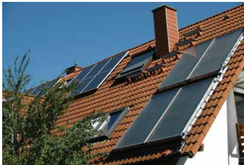
Bei der Planung und Montage einer Photovoltaik-Anlage muss auf eine korrekte Montage geachtet werden.
