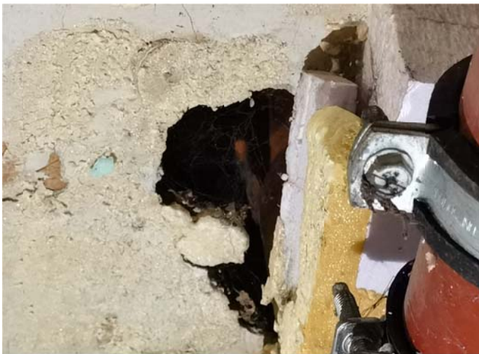
Nr. 34 Loch in Decke der Tiefgarage Hohe Wertigkeit: gute Einflugmöglichkeit, gute Haltemöglichkeit, trocken, etwas isolierend
