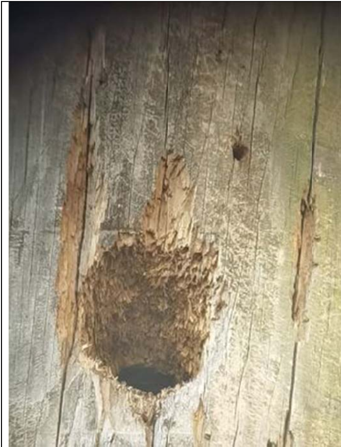
Nr. 19. Leitungsmast (Kiefernstamm), 1 Höhle
