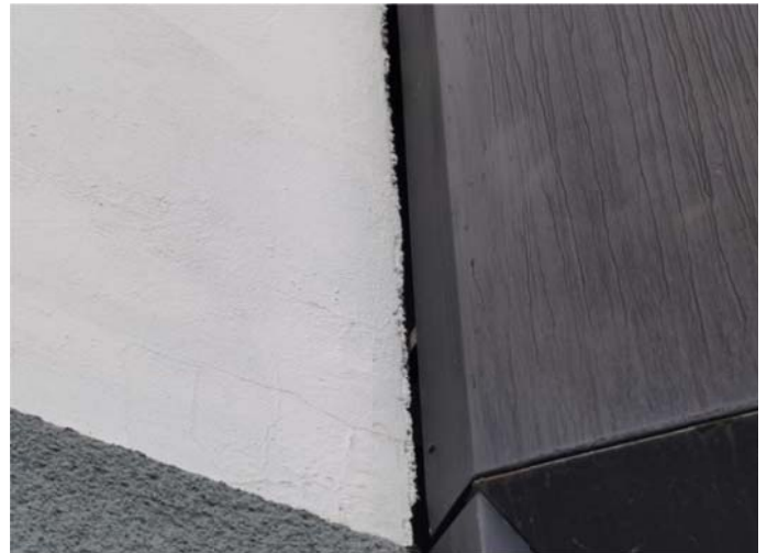
Nr. 14 Fuge zwischen Wand und Metallvorbau Geringe Wertigkeit: Einflug erschwert, Auskühlung durch Metall
