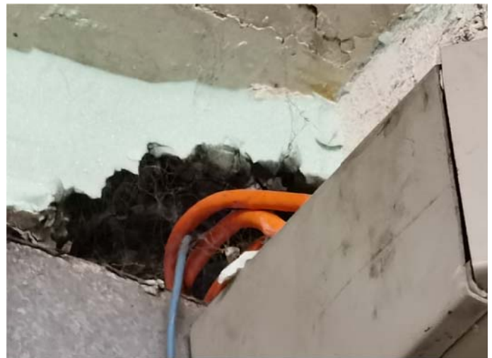
Nr. 37 Loch in Decke der Tiefgarage Hohe Wertigkeit: gute Einflugmöglichkeit, gute Haltemöglichkeit, trocken, etwas isolierend
