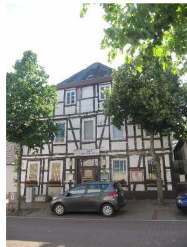
Abbildung 21: Ehem. Hotelbetrieb "Deutsches Haus" mit hohem Sanierungsbedarf
