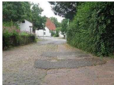
Abbildung 31: Unebenheiten in der Vormbaumstraße
