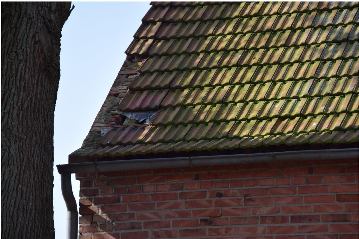
Abb. 5: Zugang zum südlichen Anbau (ehem. Stall), von Steinmardern genutzt
