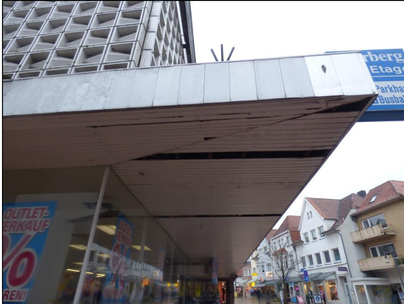
Abbildung 8: Löcher in Holzverkleidung am Vordach des Kaufhauses
