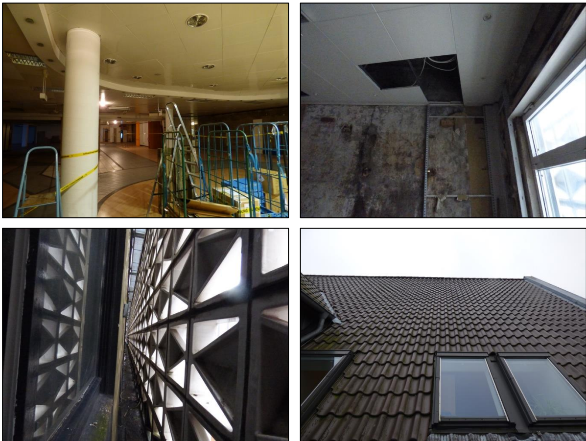
Abbildung 7: Bilder aus dem ehemaligen Deerberg-Kaufhaus von oben links nach unten rechts: leer stehende Verkaufsräume, fehlende Deckenverkleidung, Kacheln an der Außenseite des östlichen Gebäudeteils, Blick auf das intakte Dach
