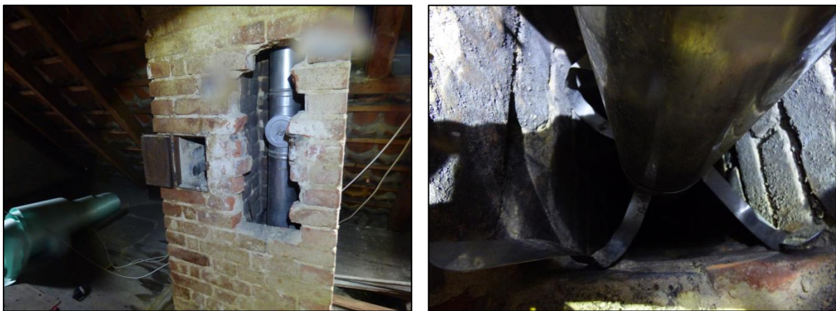
Abbildung 16: Freiliegender Schornstein mit Hohlraum
